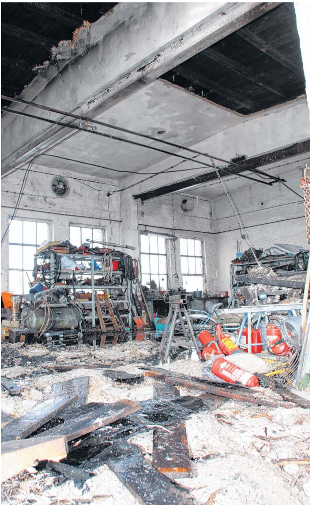
Durch das Feuer zerstört ist das Dach der Betonhalle. Die Feuerwehr musste die Deckenisolation abreißen, um die Flammen zu bekämpfen.
